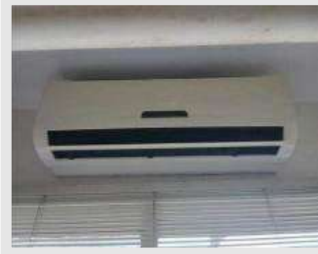
APARELHO CONDICIONADOR DE AR SPLIT MARCA ELECTROLUX POT 12000 BTU | Item: 93 |
