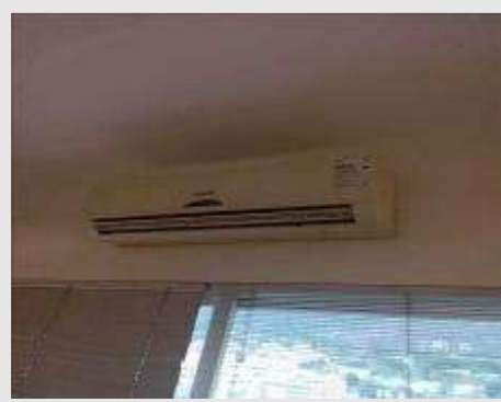
APARELHO CONDICIONADOR DE AR SPLIT MARCA YORK POT 12000 BTU | Item: 47 |
