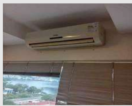
APARELHO CONDICIONADOR DE AR SPLIT MARCA YORK POT 12000 BTU | Item: 202 |
