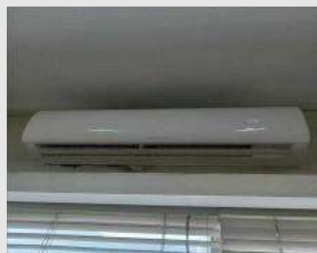
APARELHO CONDICIONADOR DE AR SPLIT MARCA AGRATTO POT 12000 BTU | Item: 353 |
